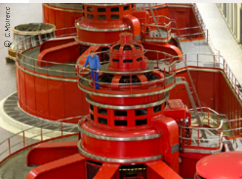
CNR - Barrage - Centrale de Genissiat
